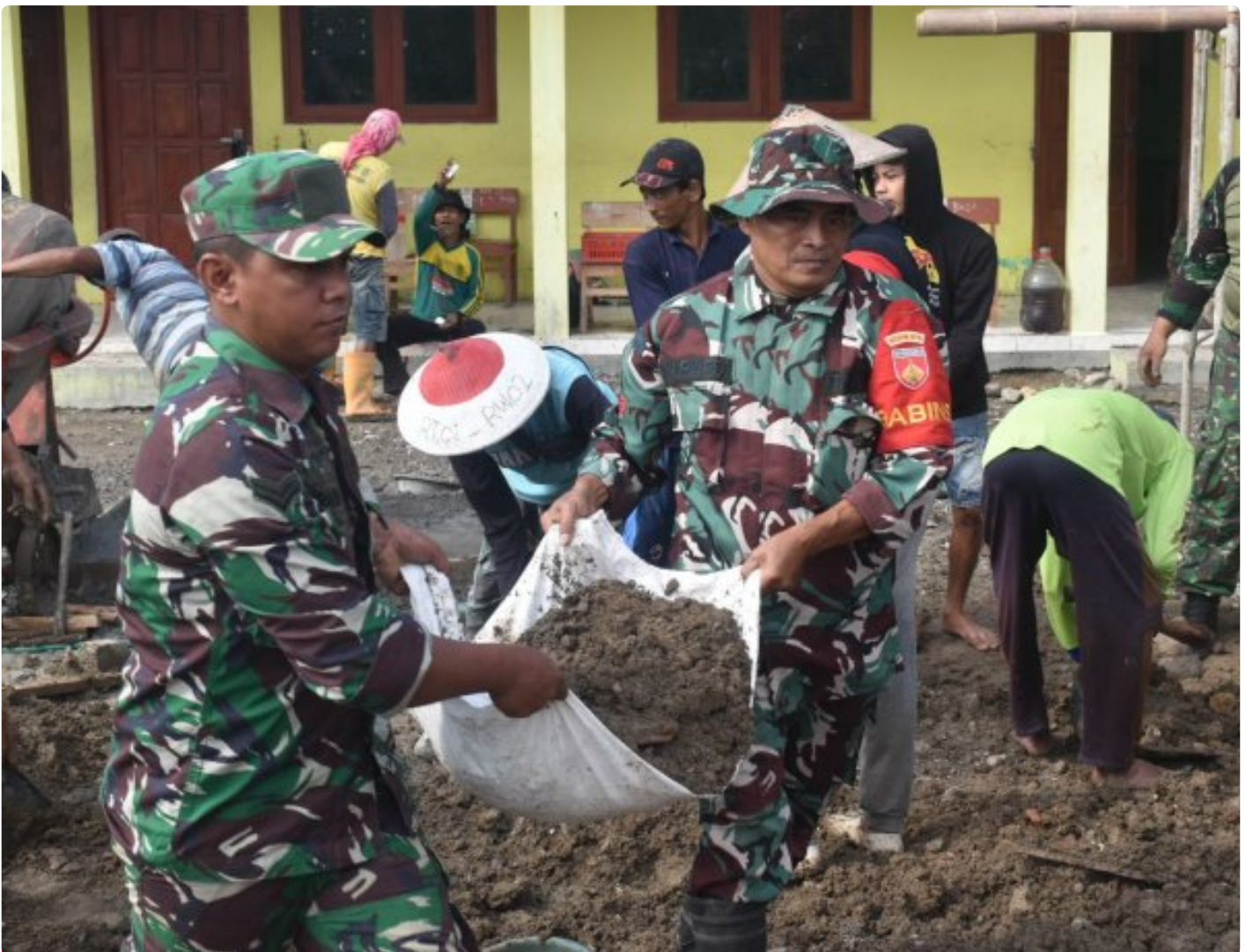
Sambut HUT TNI Ke-79, Kodim 0716/Demak Gelar Karya Bakti Pembangunan Masjid di Desa Solowire
